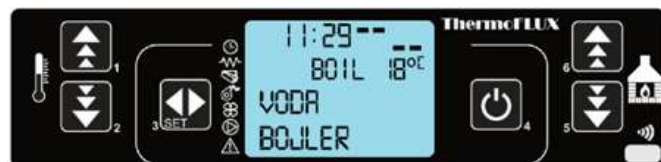
Prikaz displeja regulacije kotla Pelling u ugašenom stanju, (temp.bojlera) Prikaz 2
